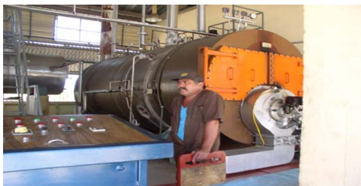
Figura 30. Área de caldera declarada “EFICIENTE”
