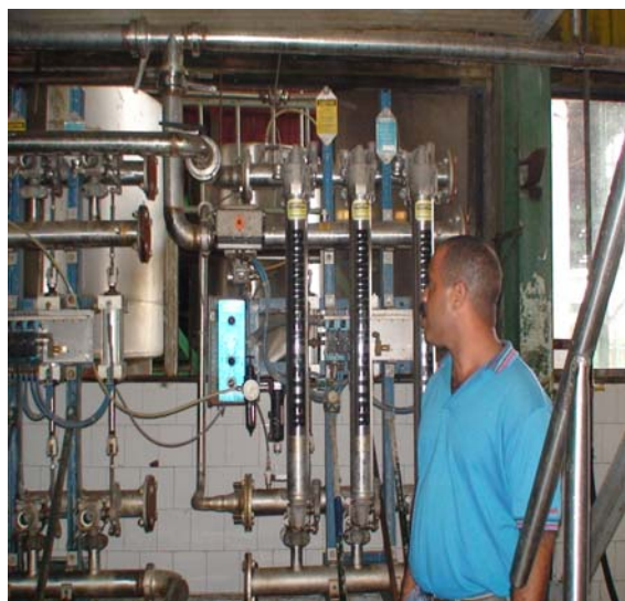
Figura 13. Filtros de aguas amarillas
