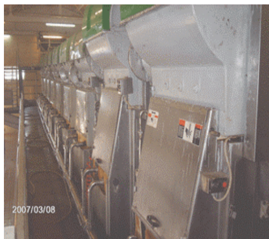
Figura 20. Cubierta de los extractores
