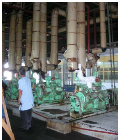
Figura 28. Aislamiento deficiente de las tuberías que conducen líquidos refrigerantes
