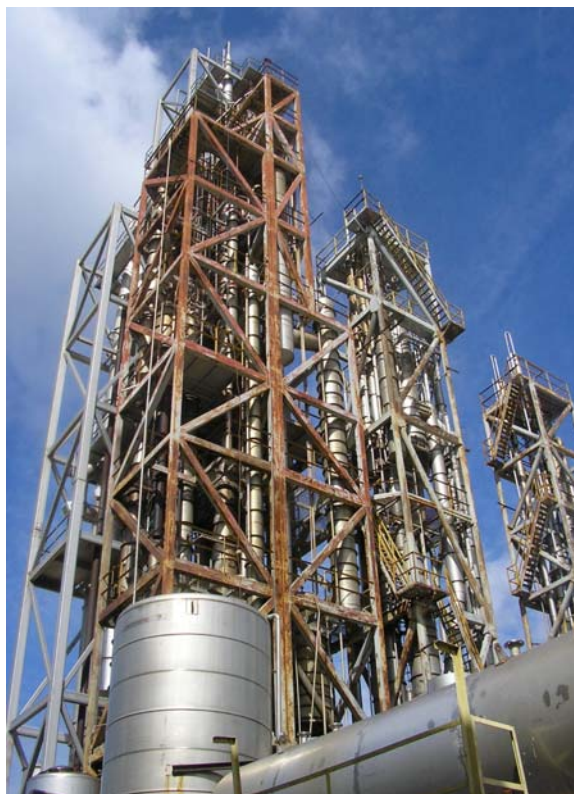
Figura 18. Tanques para la recuperación del condensado vegetal de los evaporadores
