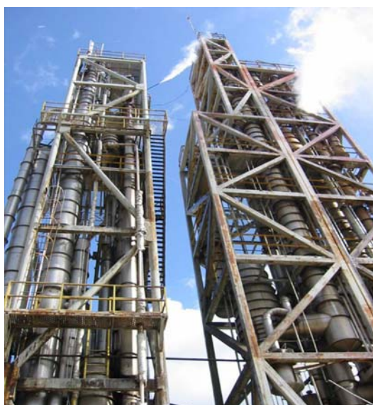
Figura 24. Trampas de vapor que funcionan deficientemente
