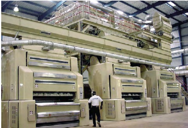
Figure 10. Trémies et gaines d'humidification du coton-graine au-dessus des alimenteurs. (Courtoisie CEC)
