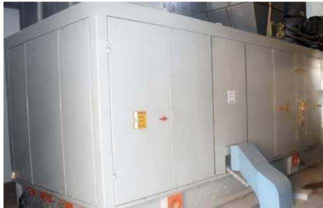
Figure 6 : Image de l'unité de cogénération de la briqueterie BBM
