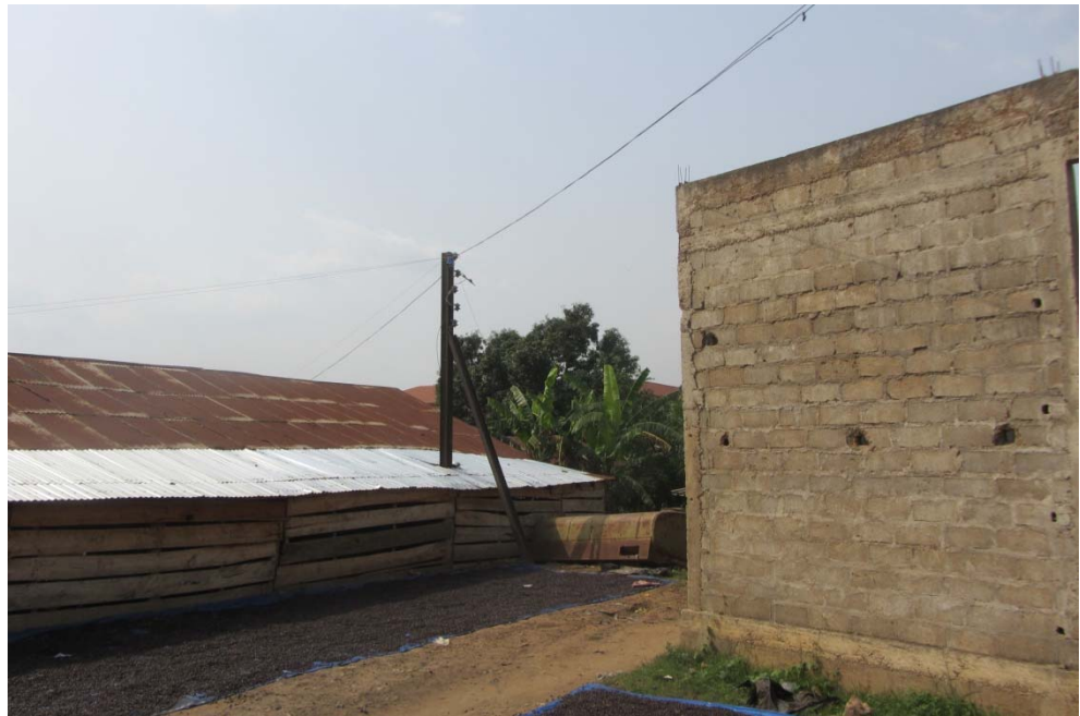
Figure 2-7 : Un poteau d'un réseau de distribution rudimentaire près de deux groupes électrogènes non-connectés
