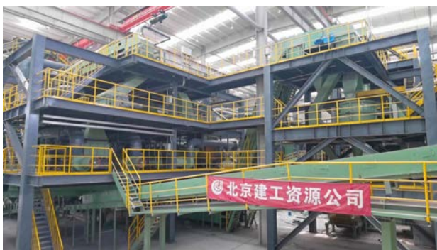
全国首例建筑垃圾领域多元化协同处置项目内部
