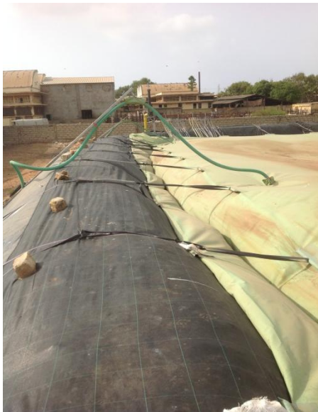
Réseau gazoduc+soupape sécurité
