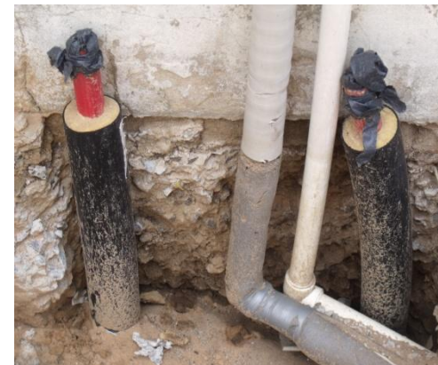
Le réseau eau chaude en attente de connexion avec le circuit de l'abattoir
