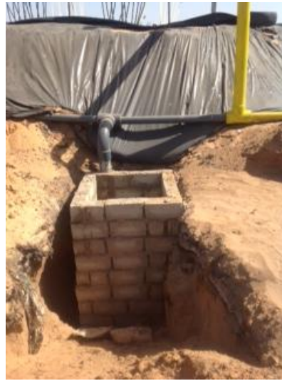
Cheminée puits condensation
